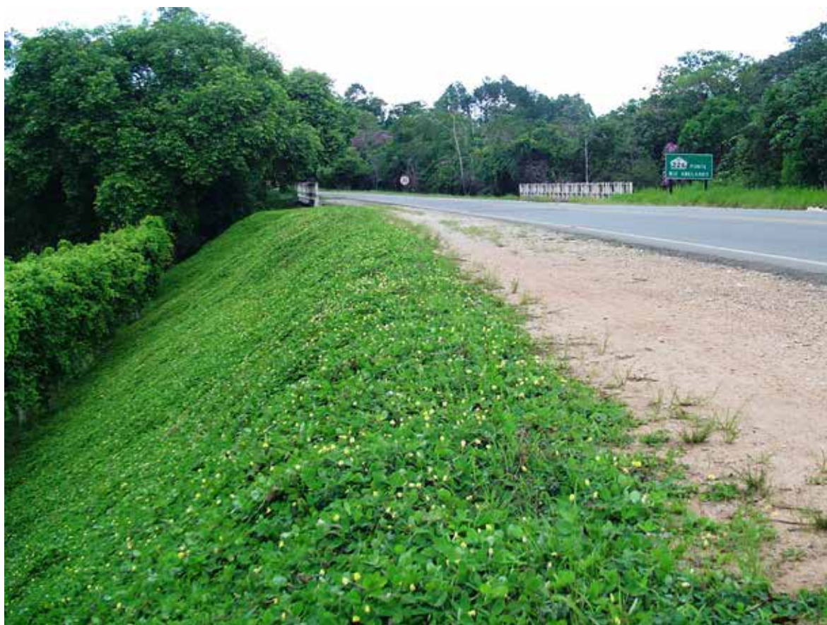
FIGURA 3. Arachis pintoi utilizado para conter erosão em talude. Foto: José F. M. Valls.
